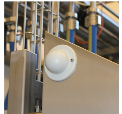
Antennen til den trådløse PROFINET-forbindelse til tavlen.
