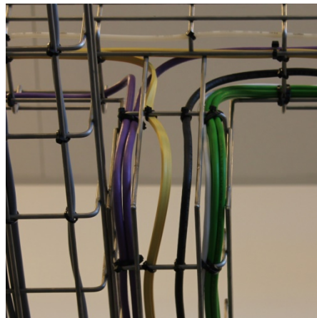
Lilla PROFIBUS DP, grønne PROFINET og gule AS-i kabler differentierer netværkene tydeligt, hvilket nedsætter fejlriskoen, hvis der skal laves indgreb fx i forbindelse med udvidelse.
